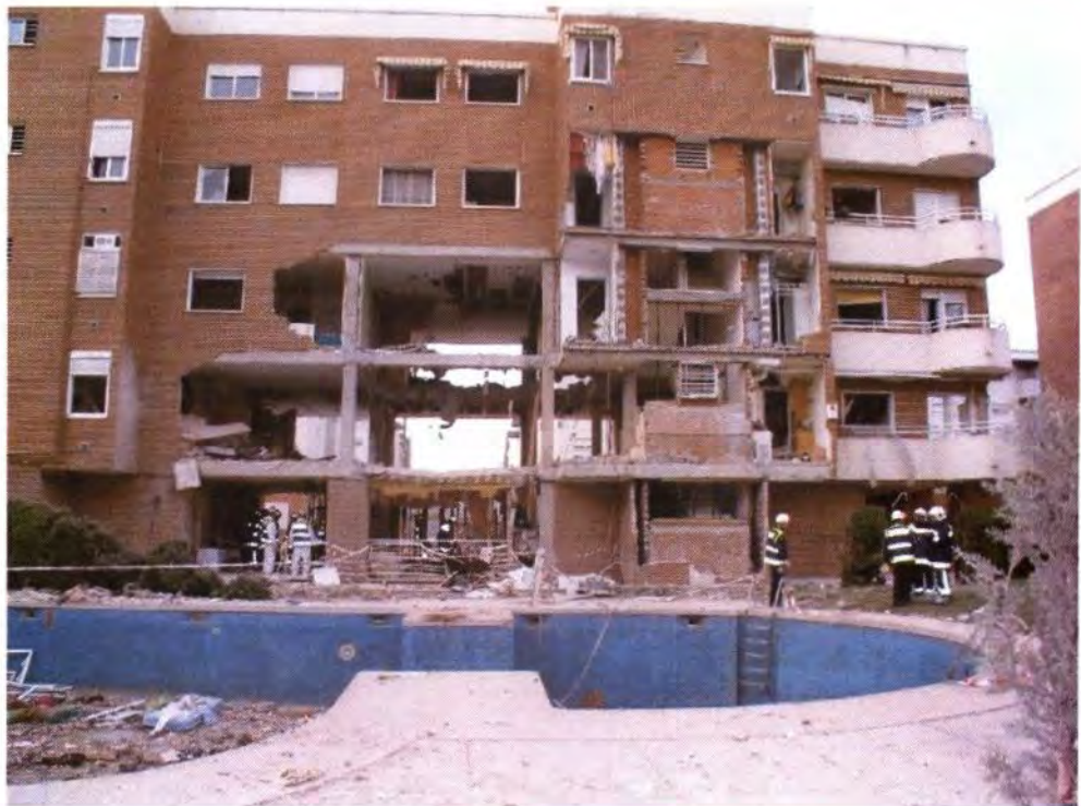
VISTA DE LOS EFECTOS DE LA EXPLOSIÓN EN LA FACHADA POSTERIOR
