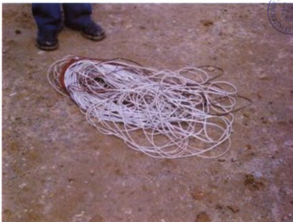
VISTA DEL CONJUNTO DEL CABLEADO
