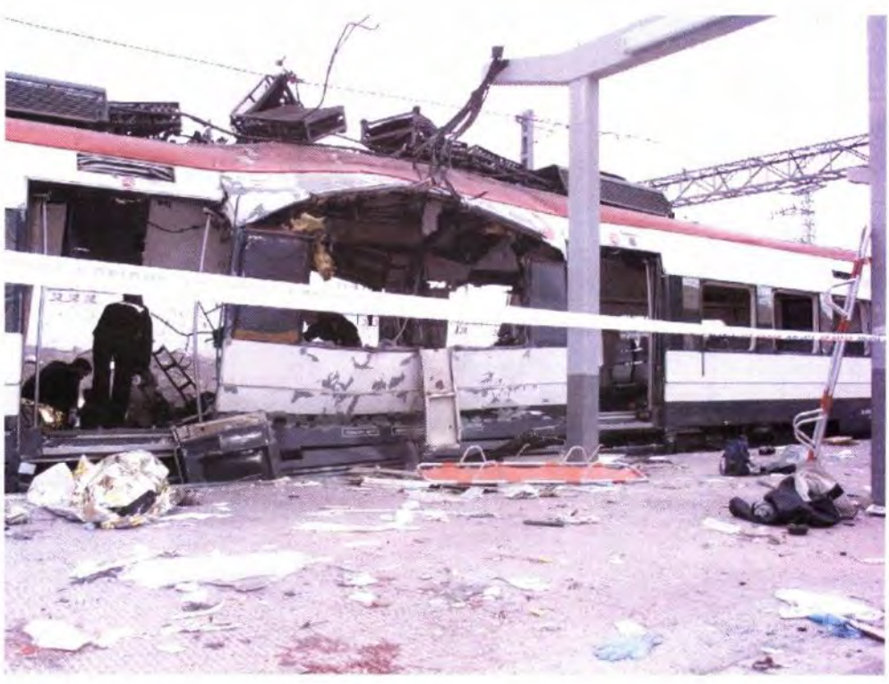
VISTA DE LOS EFECTOS DE LA EXPLOSIÓN EN AMBOS COSTADOS DEL VAGÓN
