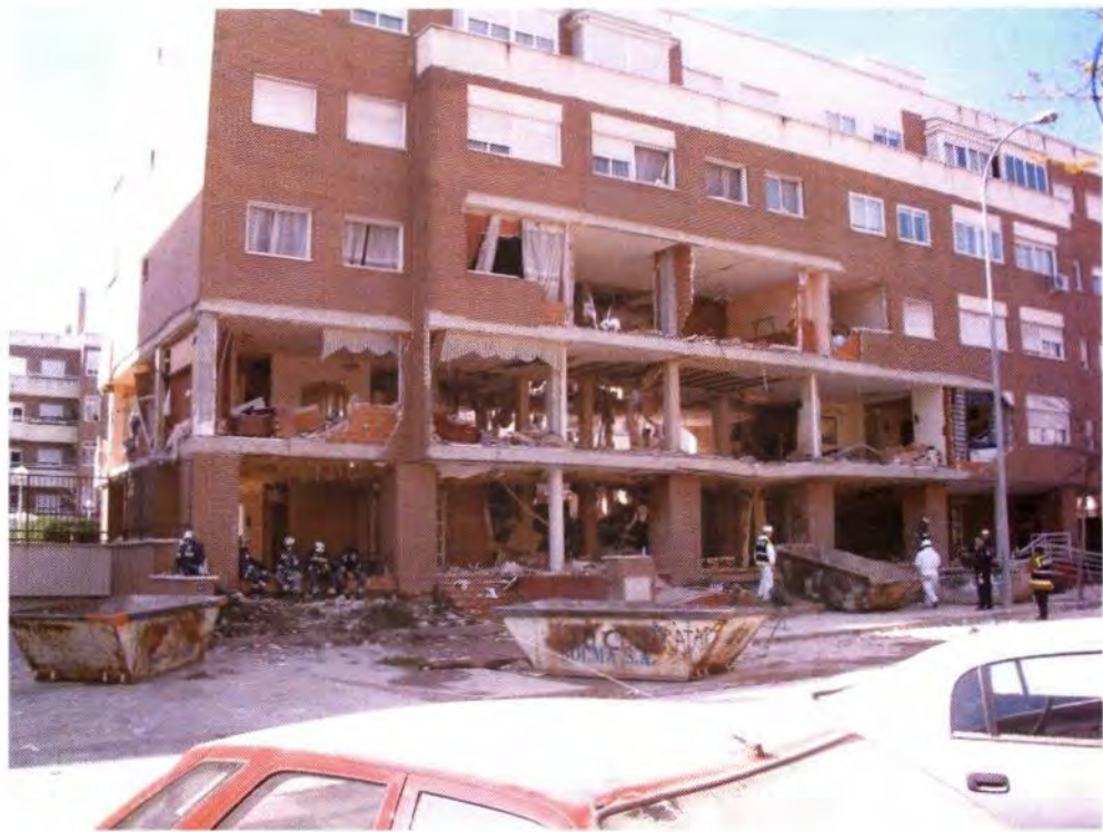
VISTA DE LOS EFECTOS DE LA EXPLOSIÓN EN LA FACHADA PRINCIPAL
